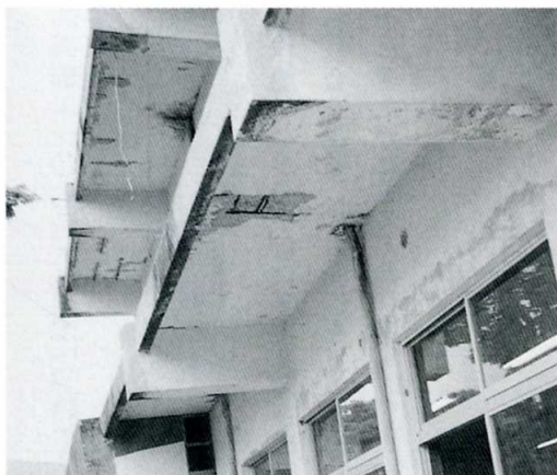
老朽化した校舎（津堅小中学校）
