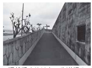
現状手すりはない歩道橋のスロープ
