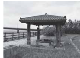
腐食が進んだ浜漁港公園のあずまや
