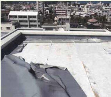
台風によって剝がれた安慶名団地屋上の防水シート
