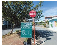
消火栓標柱・標識
