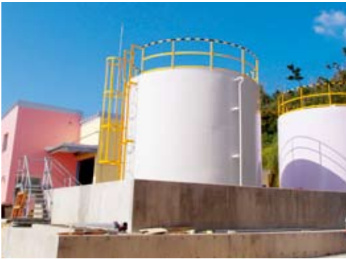
(株)エコ・エナジー研究所の精製タンク
