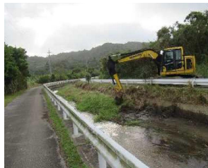
▼排水路の土砂撤去（喜如嘉）
