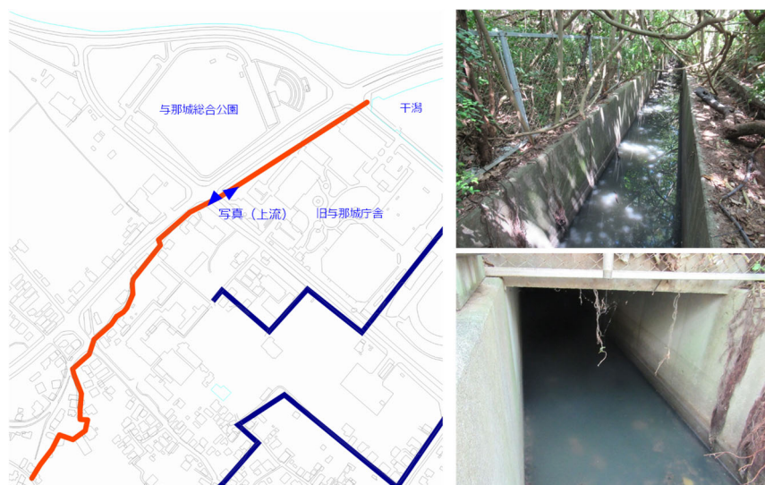
図 4.3.3 流入水路の状況
