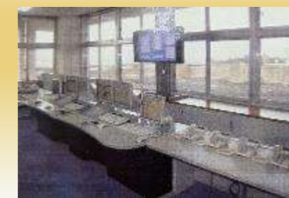
うるま市消防本部の指令台 (平成20年)石川消防署に設置 「指令制御装置Ⅱ型」
