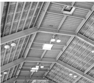
宮城小学校体育館のアスベストの様子
