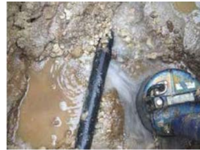
管路の漏水状況
