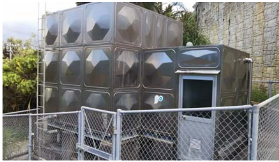
貯水槽水道の受水槽
