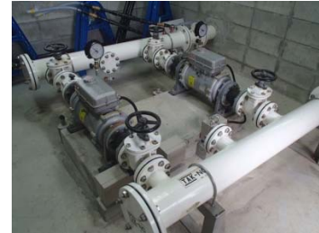
【勝連地区】 平敷屋ポンプ場
