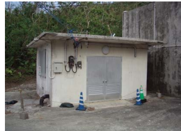
【与那城地区】 桃原中継ポンプ場 建設年度 1975(昭和 50)年度
