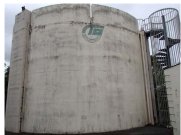
【石川地区】 警察学校前配水池 建設年度 1991(平成 3)年度
