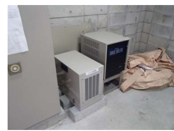
【勝連地区】 平敷屋ポンプ場 非常電源装置
