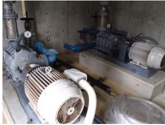
【石川地区】 警察学校前ポンプ場
