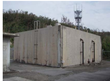
【与那城地区】 平安座配水池 建設年度 1974(昭和49)年度
