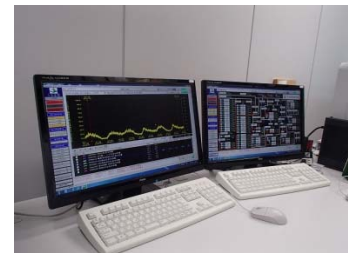
【水道部庁舎】 中央監視装置
