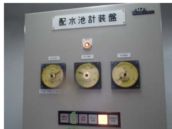
【具志川地区】 具志川配水池 配水池計装盤
