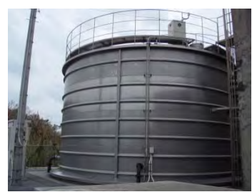
【勝連地区】 浜・比嘉第2配水池 建設年度 1998(平成 10)年度
