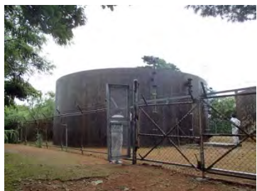
【勝連地区】 南風原第1配水池 建設年度 1988(昭和 63)年度
