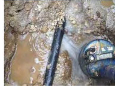
管路の漏水状況
