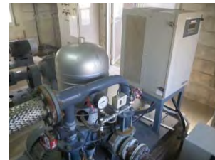
【勝連地区】 平安名増圧ポンプ所 建設年度 1990(平成 2)年度
