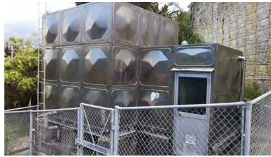
貯水槽水道の受水槽
