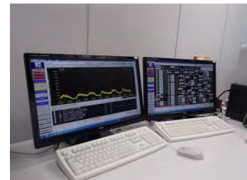
【水道部庁舎】 中央監視装置
