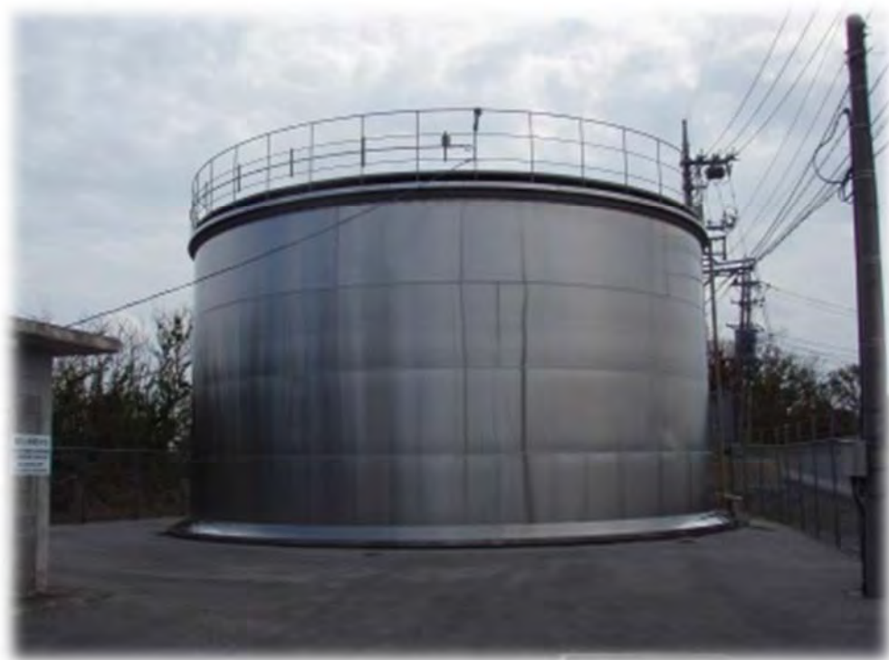
【与那城地区】第2上原配水池
