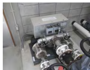
【勝連地区】 南風原増圧ポンプ所 建設年度 2010(平成 22)年度
