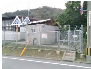
【勝連地区】 浜・比嘉ポンプ場 建設年度 1998(平成 10)年度
