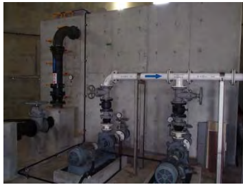
【石川地区】 東恩納ポンプ場 建設年度 2002(平成 14)年度
