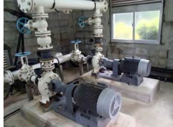
【勝連地区】 平安名ポンプ場
