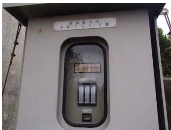
【石川地区】 高原配水池 計装テレメータ盤
