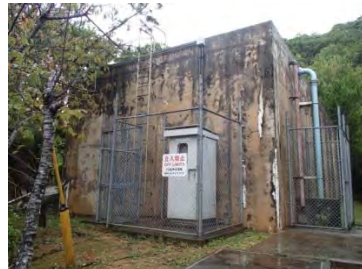
【石川地区】 第2配水池 建設年度 1973(昭和 48)年度
