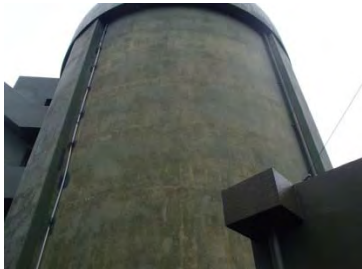
【勝連地区】 南風原第2配水池 建設年度 2001(平成 13)年度
