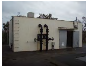
【石川地区】 警察学校前ポンプ場 建設年度 1991(平成 3)年度
