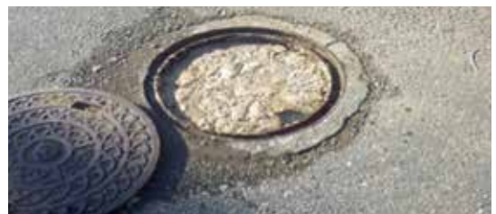
▲油による閉塞状況
