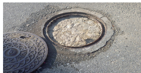
▲油による閉塞状況
