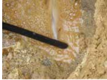
漏水箇所発見
