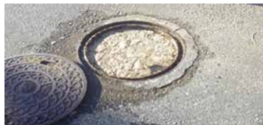
▲油による閉塞状況
