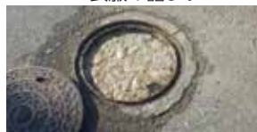
▲油による閉塞状況
