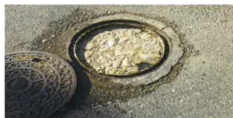
▲油による閉塞状況
