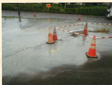
【水道】州崎地区の本管漏水(2024年)
