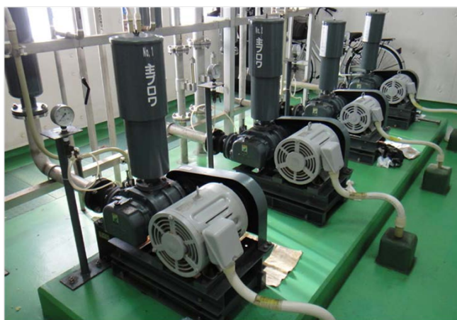
プロアポンプは隔日2台の運転のみで余力がある状況
