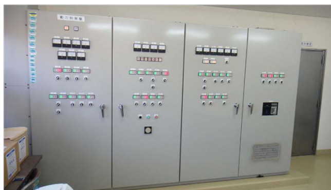
動力分電盤は適正な維持管理で状態は良好
