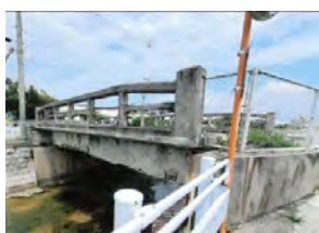
老朽化した無名橋
