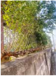
伊波中学校フェンスが腐食しているため、新設、修繕の要望をしました。
