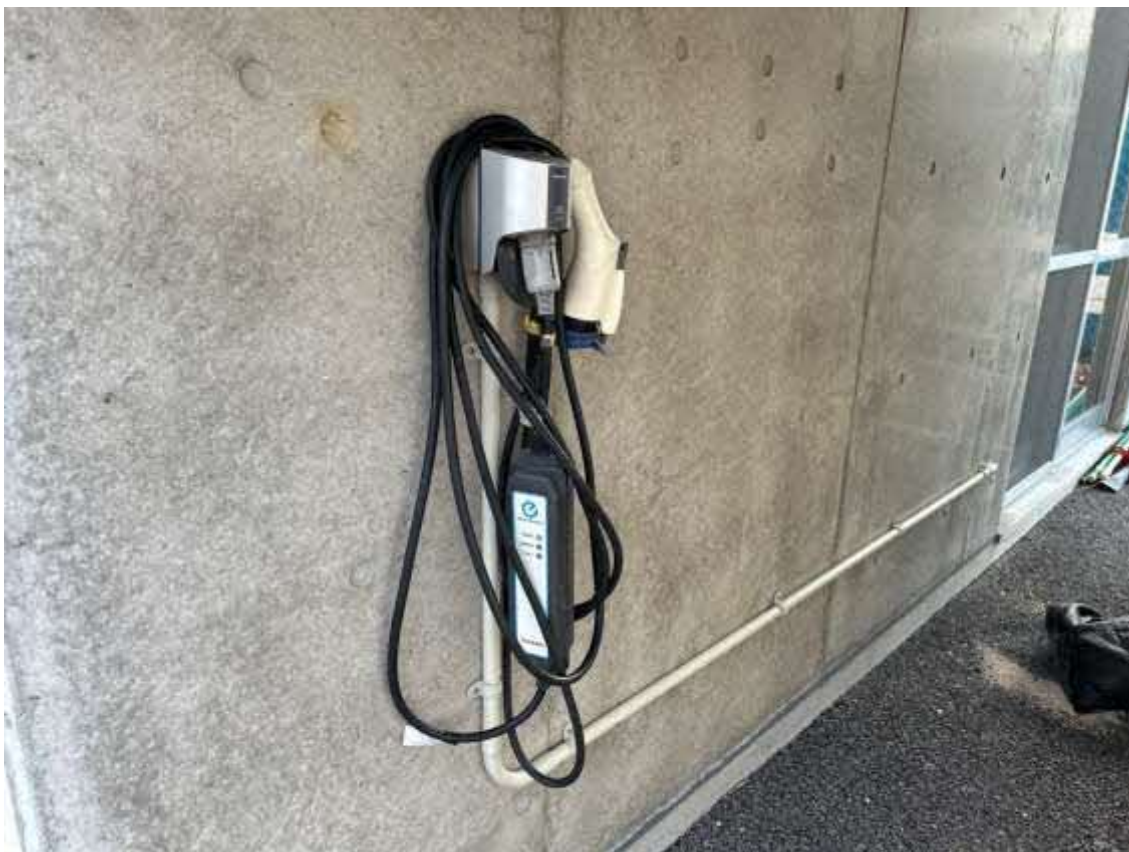
査察広報車（電気自動車）充電設備 現状写真
