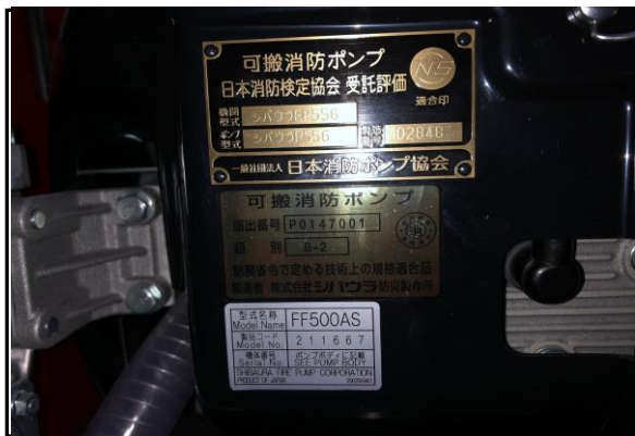
消防ポンプ検定プレート
