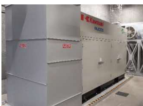
【非常用発電設備】
