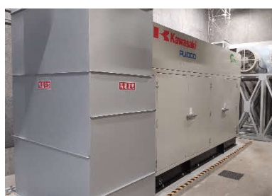
【非常用発電設備】
