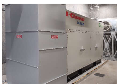
【非常用発電設備】
