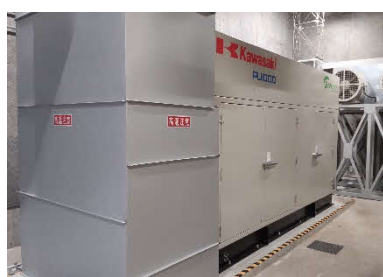
【非常用発電設備】
