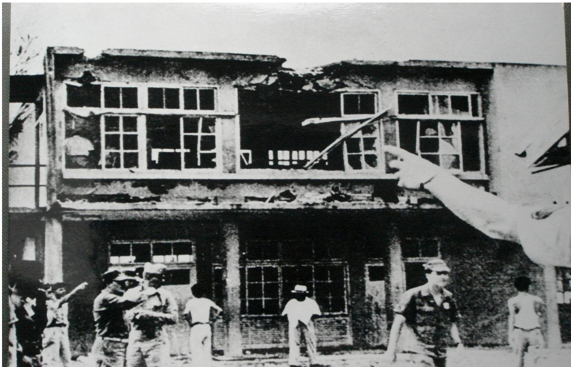
二階校舎の生々しい被害状況 昭和34年（1959） 上
