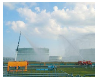
石油タンクへの一斉放水の様子
