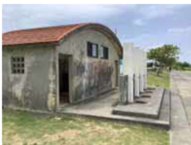
図 老朽化したトイレ
