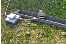
既存暗渠内配管
