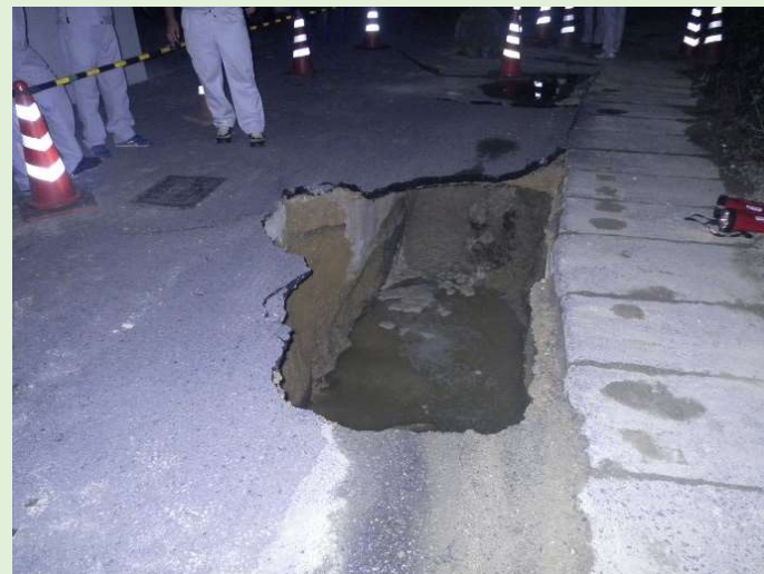
宮里区内の本管陥没（2016.7月）
