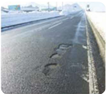
路面の穴ぼこ・ 段差
