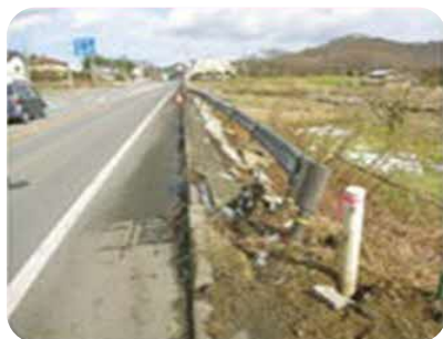
ガードレール・ 標識等の損傷
