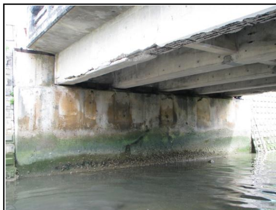
【健全度 20～30 点未満の橋梁の例】
